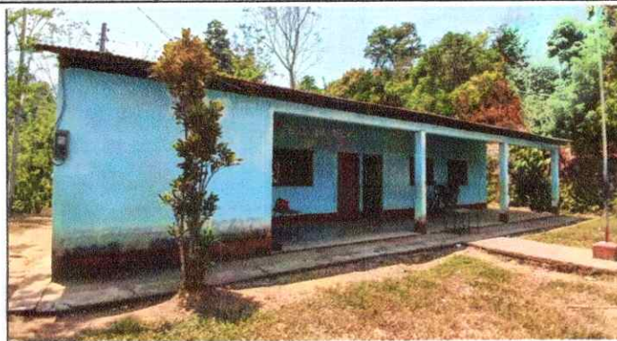
Foto 8: Se observa la humedad en la pared de la infraestructura escolar y es necesario su mantenimiento en pintura exterior e interior.
