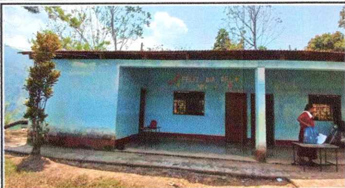
Foto 7: Se observa que el Edificio Escolar necesita Canales Pluviales.
