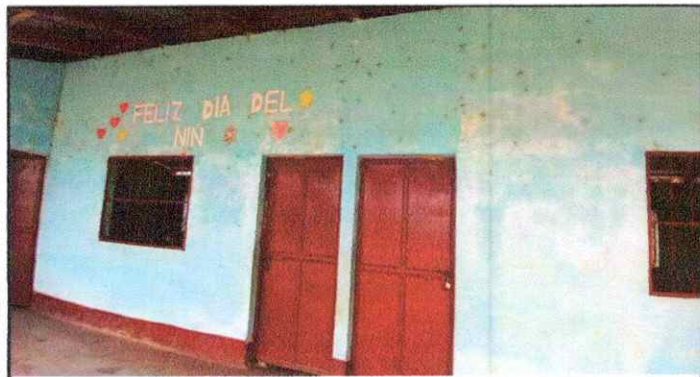
Foto 3: Las puertas de las Aulas estan Deterioradas y en pesimas condiciones.
