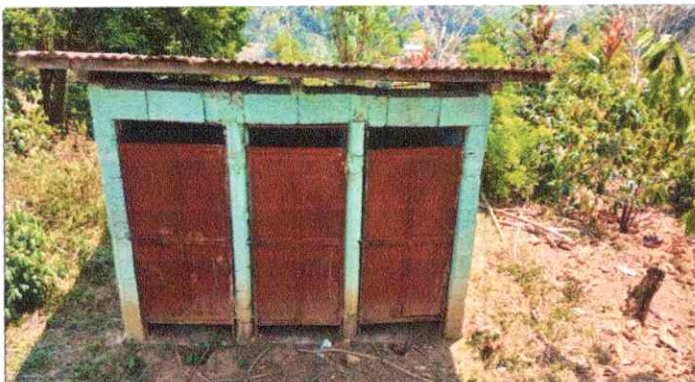
Foto 9: Se observa el Deterioro del Sanitario o Letrina es urgente remozar y su mantenimiento.
