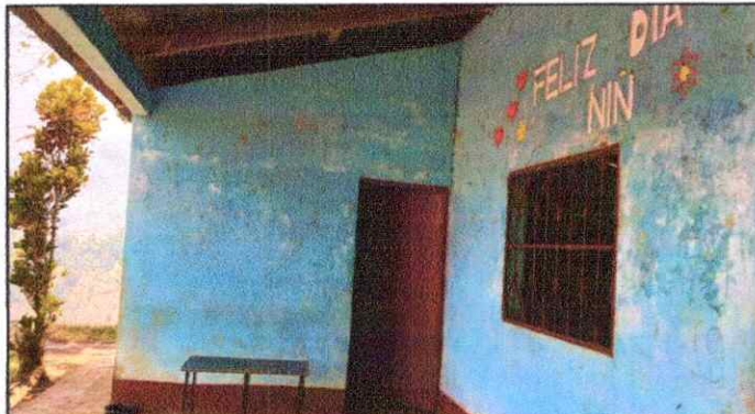
Foto 4: Se observa El Deterioro de la Puerta de la Dirección de la EORM.
