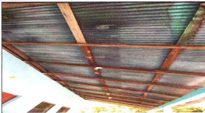
Foto 2: Se observa realmente que la estructura de vigas o costaneras no es la adecuada para el establecimiento. Esta deterioro
