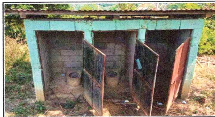
Foto 10: Se observa que los inodoros ya no están en condiciones para la salud. Es prioridad el mantenimiento.
