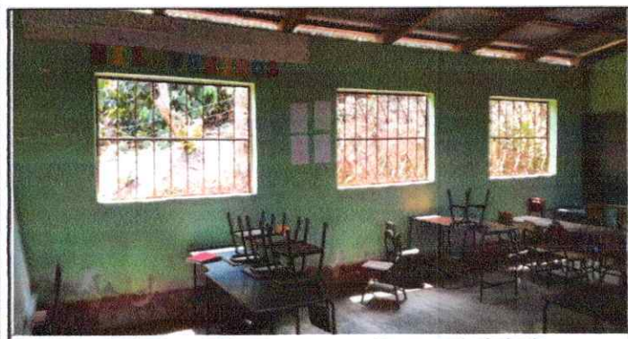
Foto 5: Los Balcones se Observa que necesita un mantenimiento.
